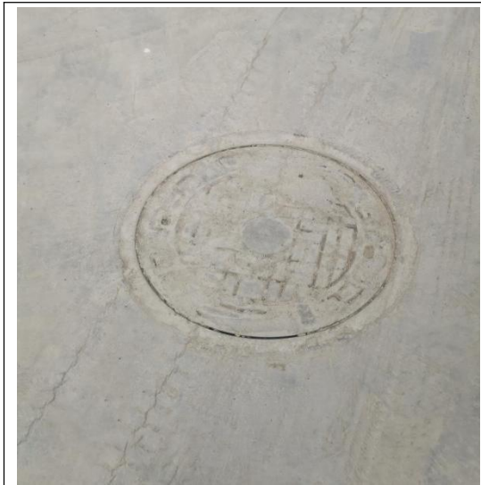
地下水监控井
